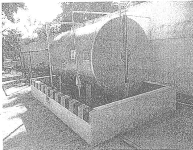
Foto 8. Tanque de almacenamiento de ACPM. Capacidad 2000 galones. Almacenamiento promedio 250 galones. Cuenta con sistema de contención de derrames.
